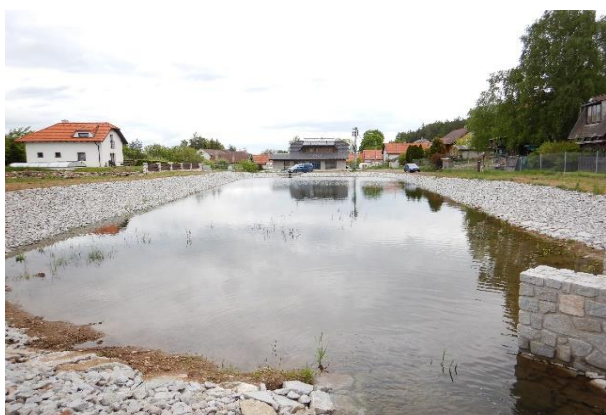
KB na Bytízském potoce (vodní nádrž na tomto toku) v zástavbě obce Dubenec
